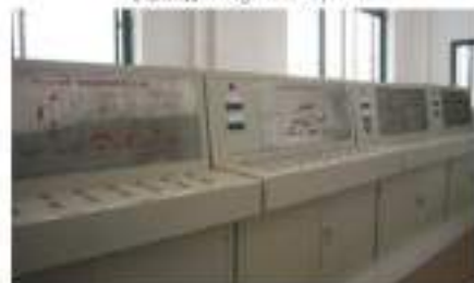
电气控制系统 Electrical Control System
