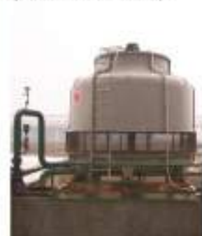
凉水塔 Cooling Tower
