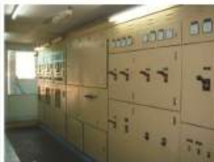
配电室 Power Distribution Room
